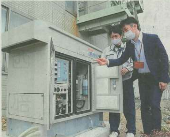
脳リハビリネットワークが運営施設のすぐ横に新設した非常用LPガス発電機＝浜松市西区志都呂
